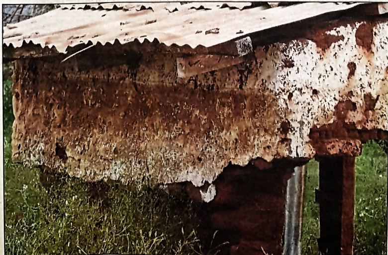
Der Bedarf ist weiterhin groß, die zerstörte Toilette muss beispielsweise ersetzt werden, ebenso mehrere Klassenräume.
