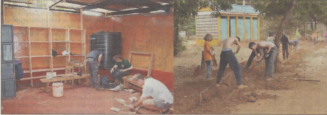
Das Foto zeigt den neuen Anbau mit selbstgeziimmerten Regalen und einem Trinkwassertank sowie die Verlegung einer Wasserleitung.
