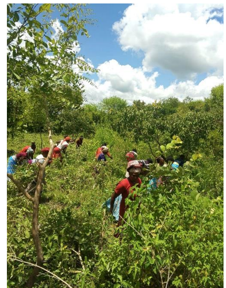
Eltern bei der Rodung des Geländes für die neuen Toiletten und die Schulküche
